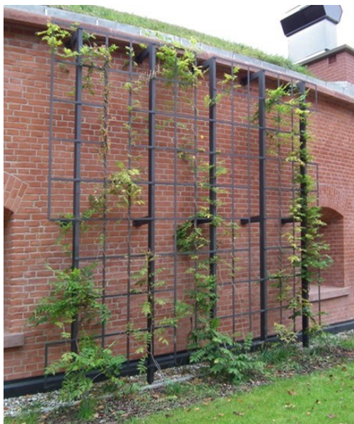
Ryc. 39. Konstrukcje dla pnączy na elewacjach.
