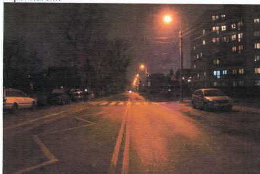
Rys. 9.13 Widok instalacji oświetleniowej – przypadek 1
